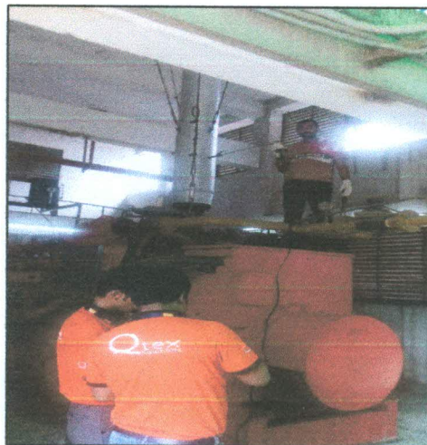
Fig: Generator ((5283701689(G-02))
